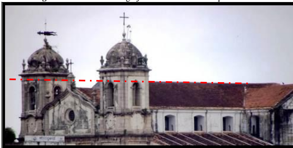
Figura 164 - Telhado da Igreja do Carmo mais alto que a fachada
