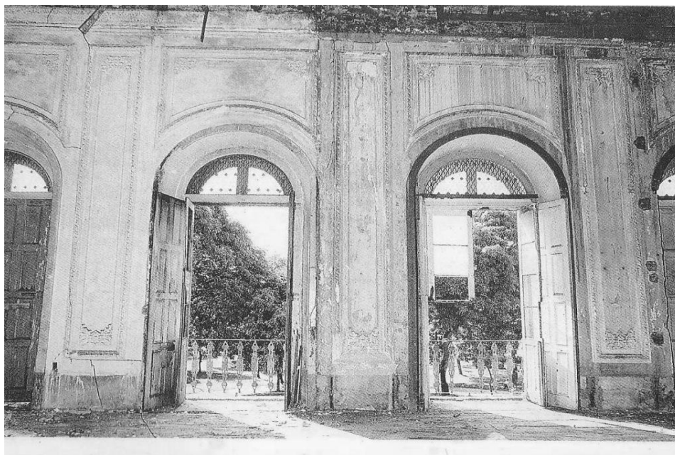
Figura 60 – Cenário interno desolador: o palácio é uma ruína
